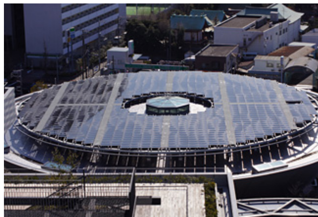
羽田クロノゲート内スポーツ施設屋上の太陽光パネル
