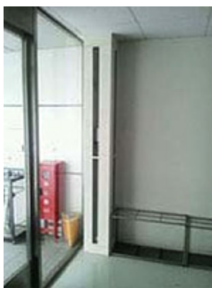
エアカーテンの設置によって外気を遮断 (ヤマトシステム開発)
